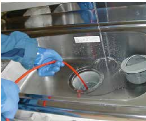
排水管の内部を高圧洗浄車を使って洗浄。 つまりの原因となる異物を除去します。
